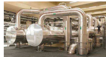
TVO. Les condensateurs d' Oluiluoto.
