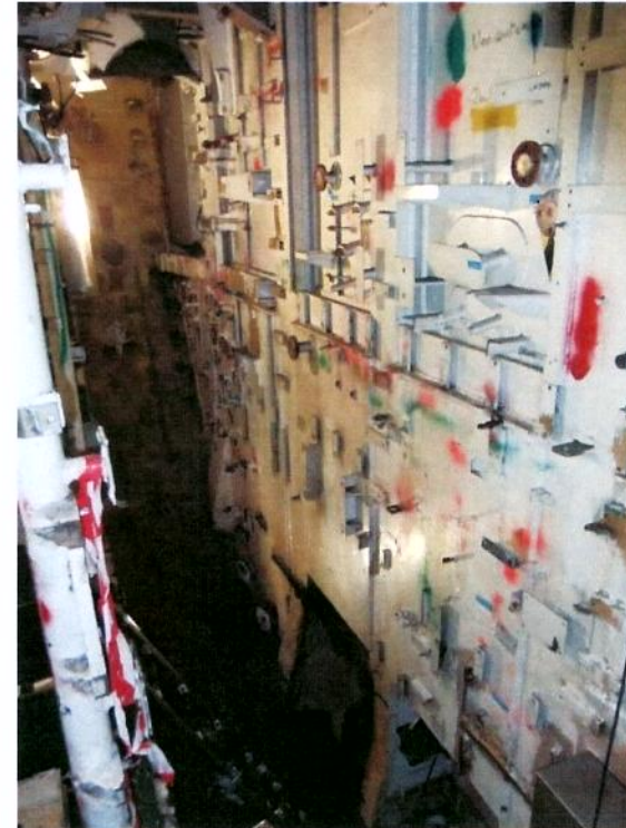
Niveau II : confinement du CRE côté cloison 68
