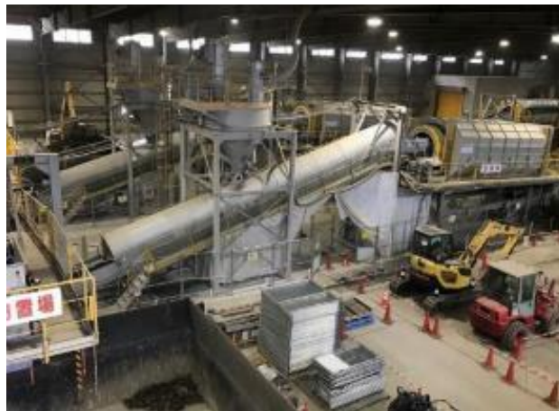
Installation de tri (Okuma)
