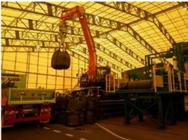
Installation de tri (Futaba)
