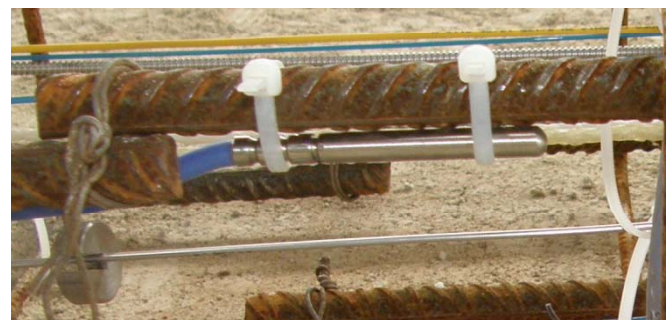
Capteurs de déformations
