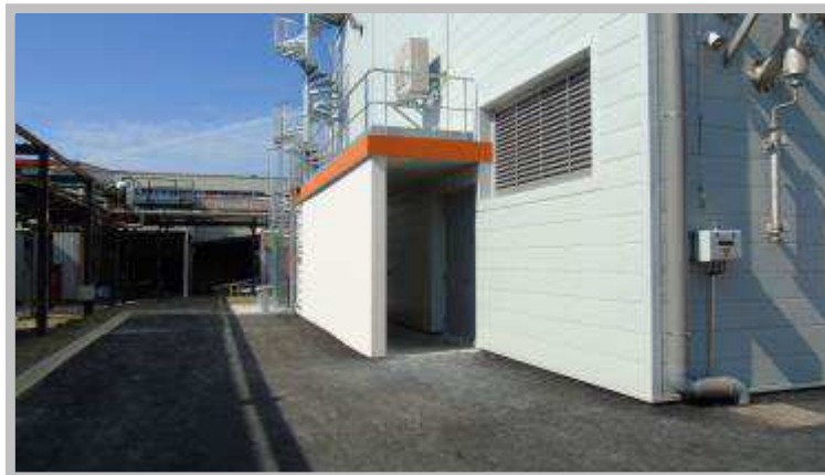
Protections entrées bâtiment et local GE
