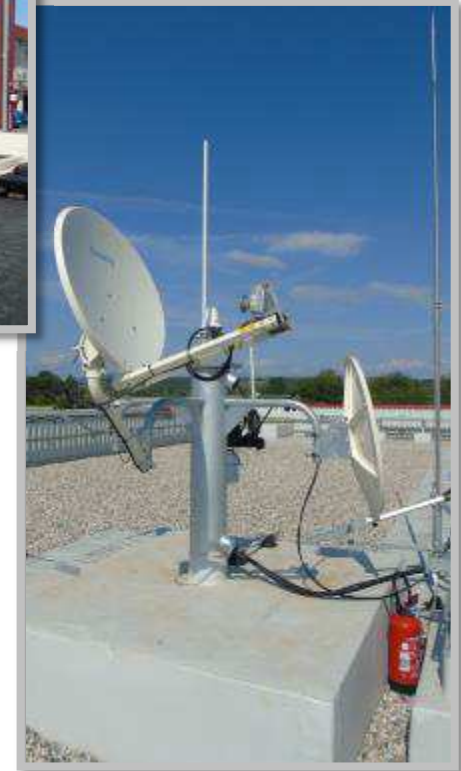
Antennes station météo
