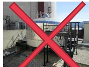
Filtre à sable
